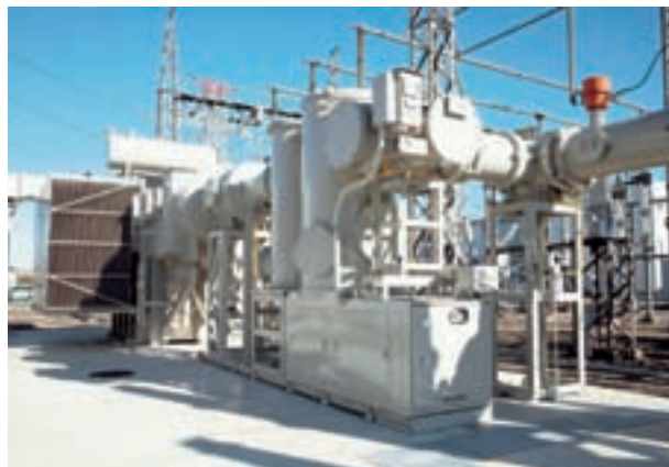
一般電力用変圧器ガス絶縁開閉装置
