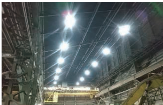
トランスヤード天井照明
