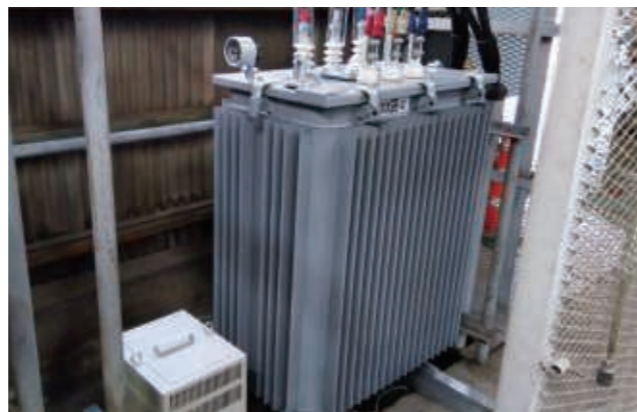
コンプレッサー室変圧器
