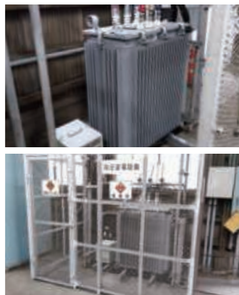
コンプレッサー室変圧器
