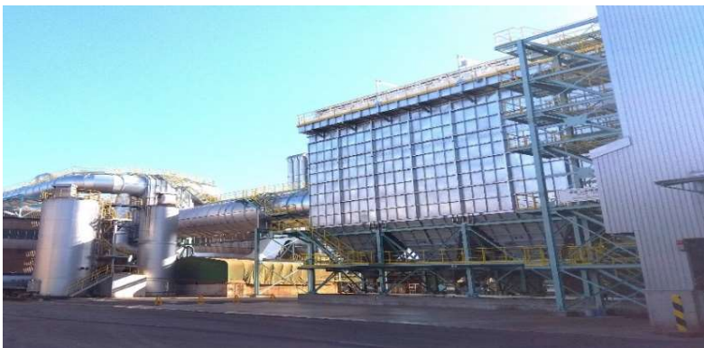
更新後の集塵機
